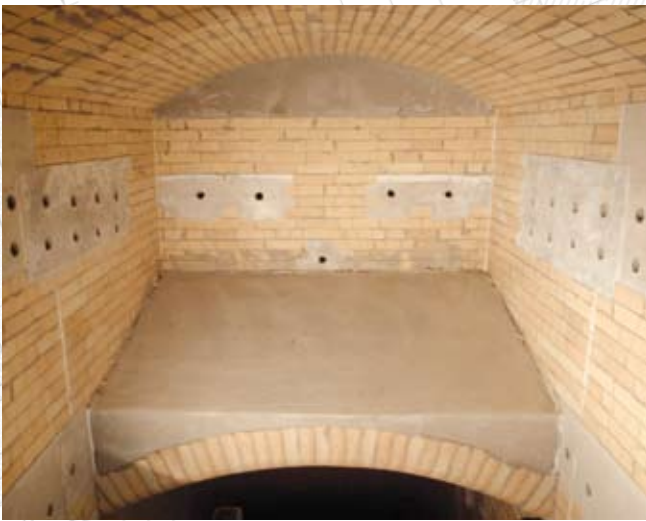
Ofenraum im Bereich der Nachverbrennung
